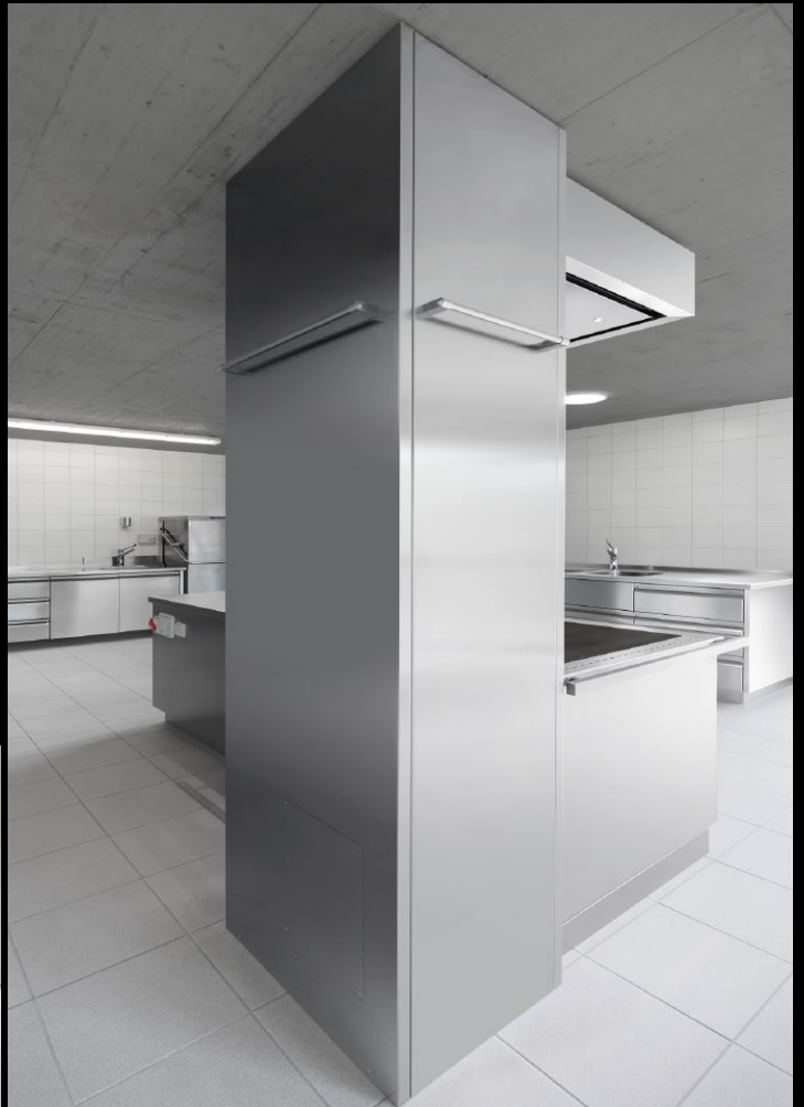
Säule komplett in Edelstahl verkleidet
